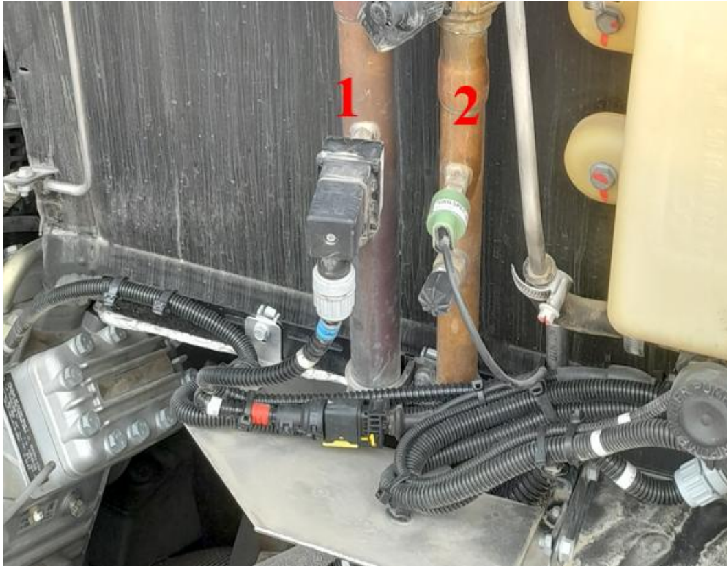
Figura 16. Sensores de presión del líquido refrigerante del sistema de Aire Acondicionado.
